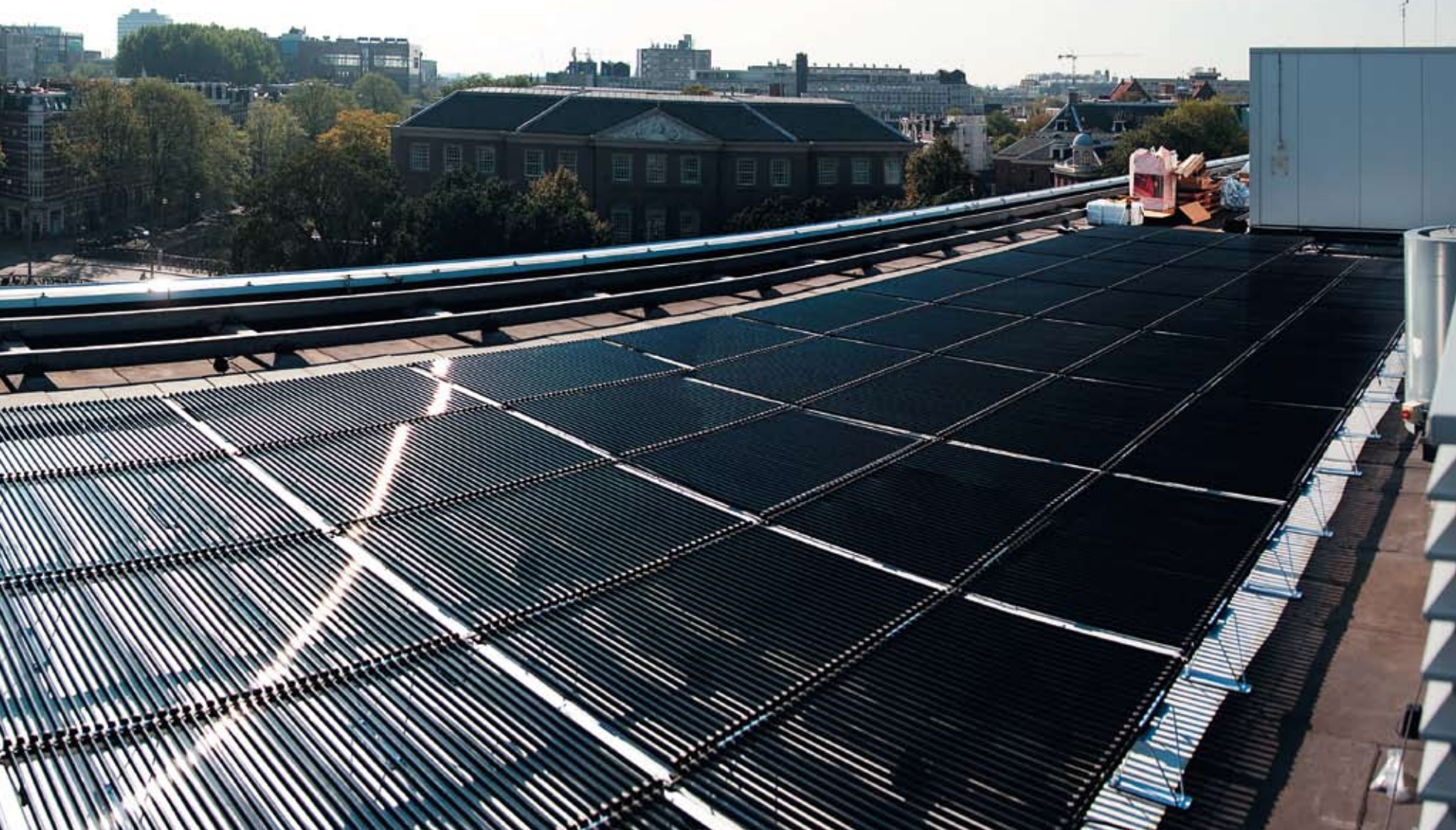
De zonnepanelen op het dak van het B.C.P. Jansen Instituut. Op de achtergrond het Roeterseilandcomplex.
